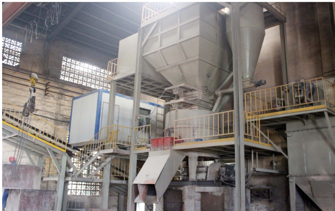
▲水玻璃砂生产线
